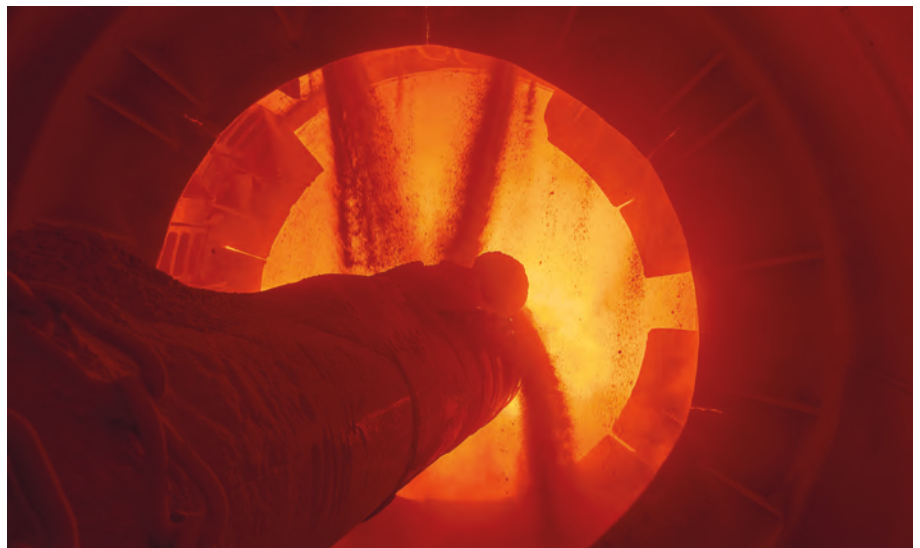
Blick in die Brennkammer des Drehrohrofens einer Zementfabrik; im Artikel werden verschiedene Szenarien hinsichtlich der Bereitstellung industrieller Prozesswärme verglichen
