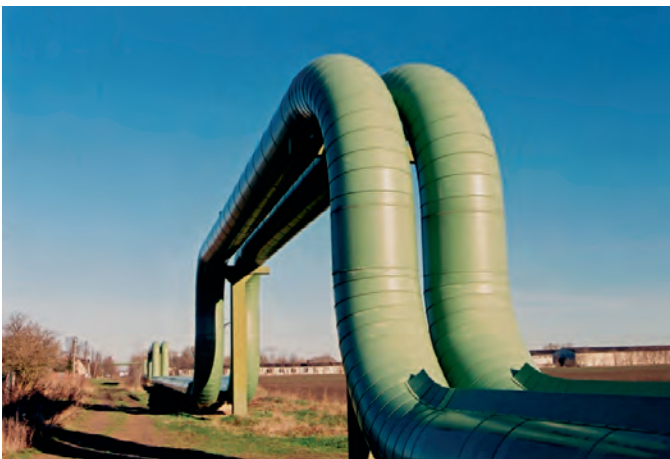
Fernwärme in Magdeburg
