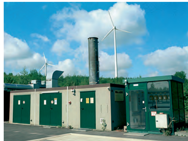
Deponiegas wird in Hamburg zur KWK genutzt
