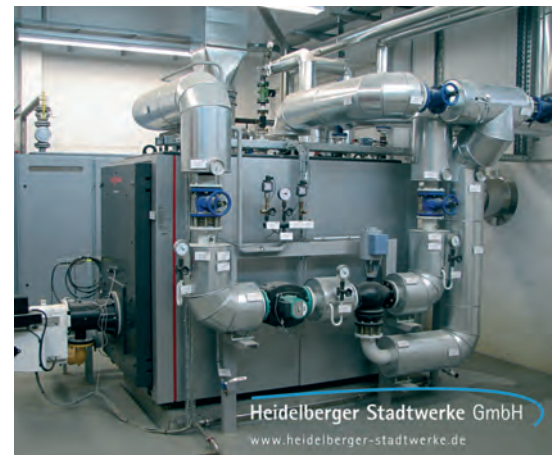
Klärgasnutzung in Heidelberg
