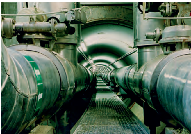
Abwasserleitung in Magdeburg
