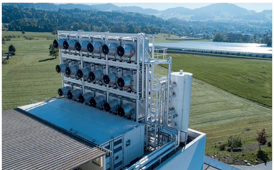
Die weltweit erste kommerzielle Direct Air Capture-Anlage steht in in Hinwil/Schweiz Bild: Climeworks / Julia Dunlop
