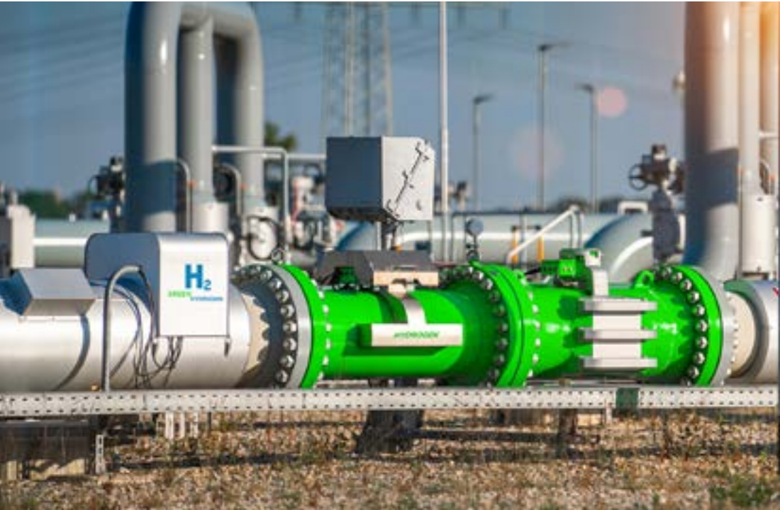
Um grünes Wasserstoffgas für sauberen Strom, Solar- und Windenergieanlage herzustellen (im Bild Wasserstoff-Erzeugungspipeline), muss Deutschland in den kommenden Jahren die Produktionskapazitäten von Elektrolyseuren stark ausbauen.
