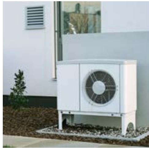
Energetische Sanierung: Werden Häuser an klimafreundliche Wärmenetze (links) angeschlossen oder mit Wärmepumpen (rechts) ausgestattet, verbessert das die Energieeffizienz deutlich. Quelle: GettyImages
